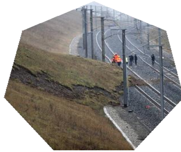
GLISSEMENT DE TERRAIN
